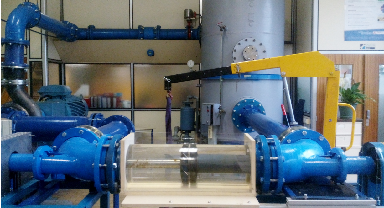
FIGURE 5.2 – Banc d'essais, le circuit hydraulique du laboratoire
