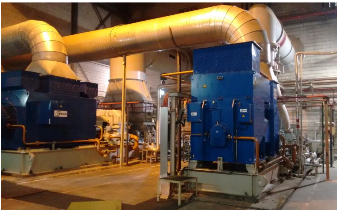
Imagen 36 Turbinas de vapor
