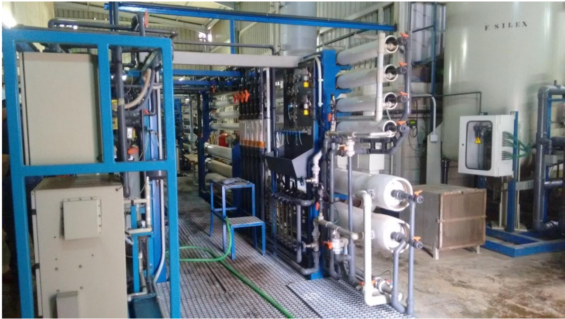
Imagen 47. PTA. Planta de tratamiento de agua
