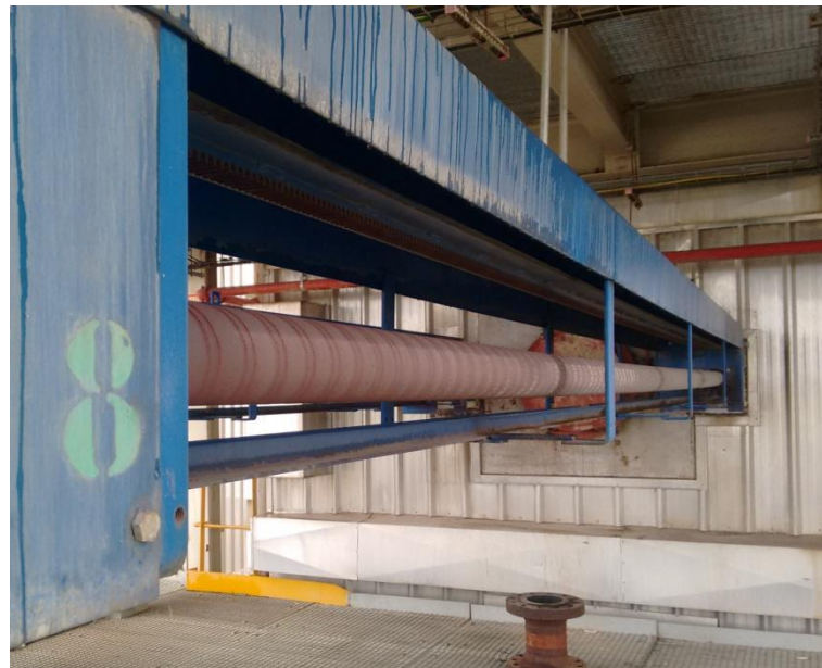
Imagen 39 Sopladores del sobrecalentador
