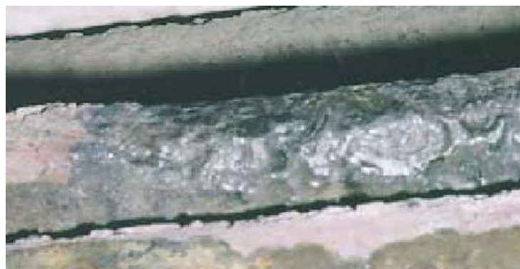
Imagen 43 Corrosión y erosión en tubos del sobrecalentador
