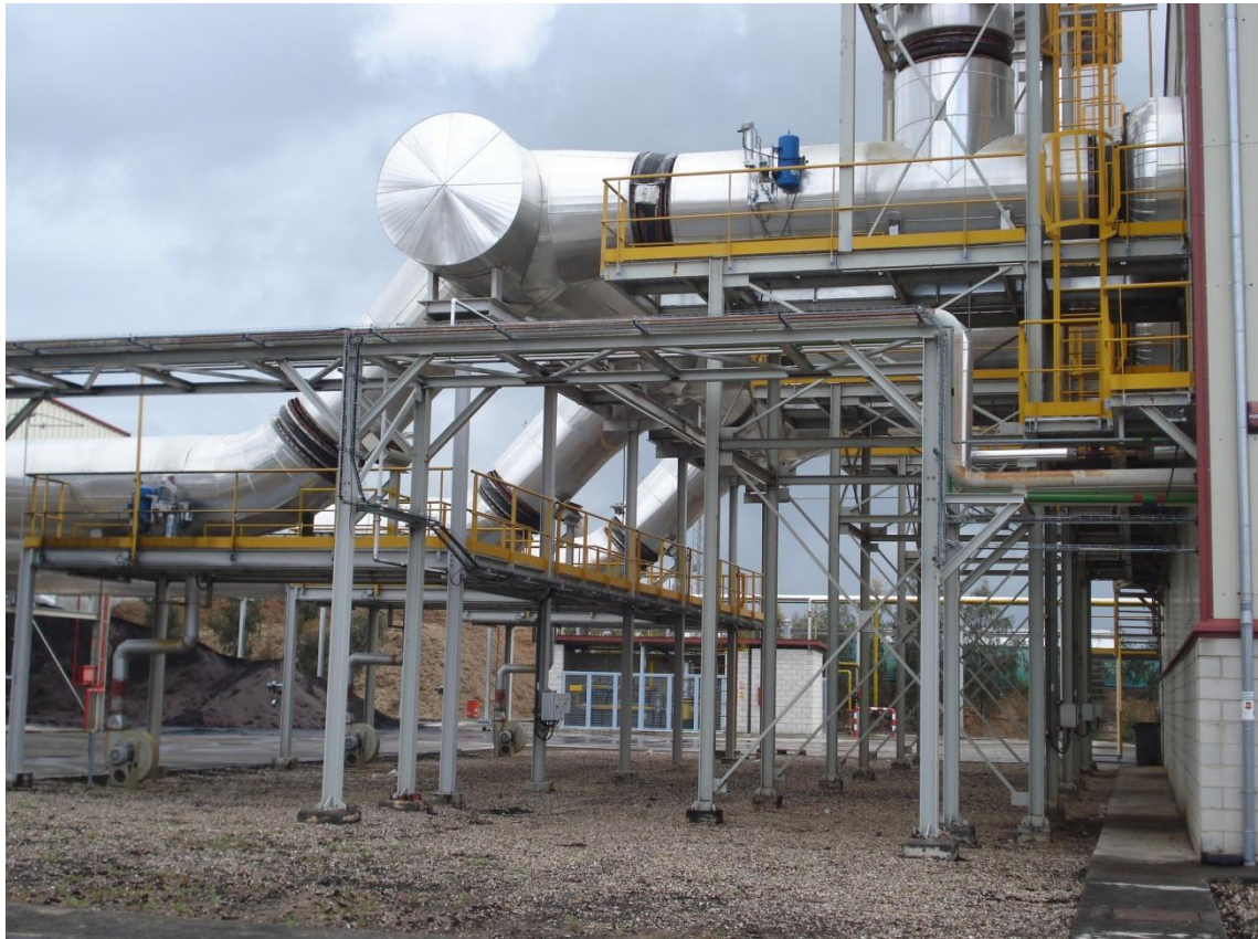
Imagen 26. Entrada de gases provenientes de la turbina de gas a secaderos
