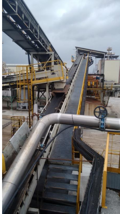
Imagen 21. Sistema de transporte. Cinta transportadora
