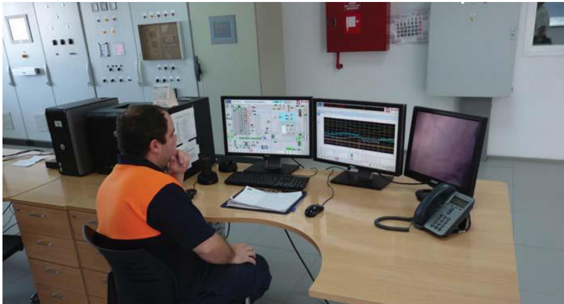
Imagen 50. Sala de control
