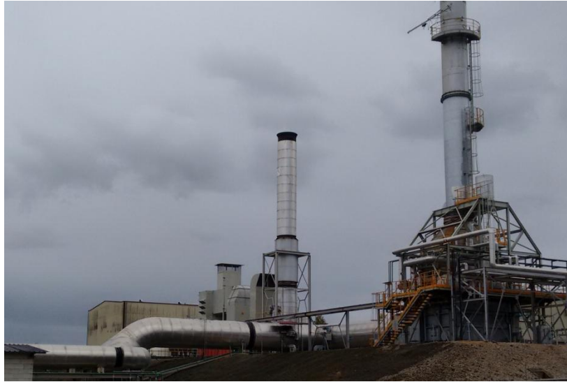
Imagen 35 Turbina de gas y caldera de recuperación
