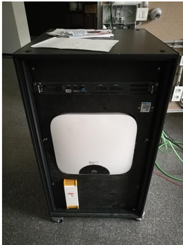
Ilustración 23. Estructura para el montaje del inversor con el inversor colocado.
