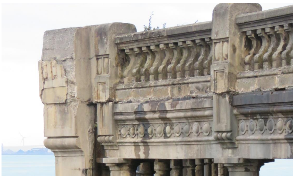
Figura nº 42. Fractura con desplazamiento en la base de la balaustrada de la crujía 48 nivel 2.
