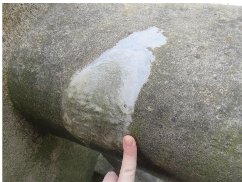
Figura nº 54. Costra cálcica (D4a) Sobre el barandal superior del modelo a en la zona del tholos tramo 29 nivel1.2019.
