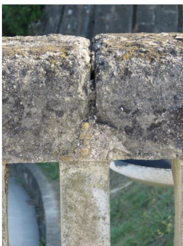
Figura nº 50. Erosión diferencial en el mortero de unión entre los barandales superiores del modelo A. Tramo 1* Nivel 3
