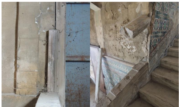
Figura nº 31. Marcas en la decoración y fragmento de barandal encastrado en la pared.2018.
