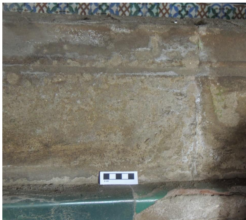
Figura nº 63. Detalle de las eflorescencias salinas en uno de los barandales inferiores.2018.
