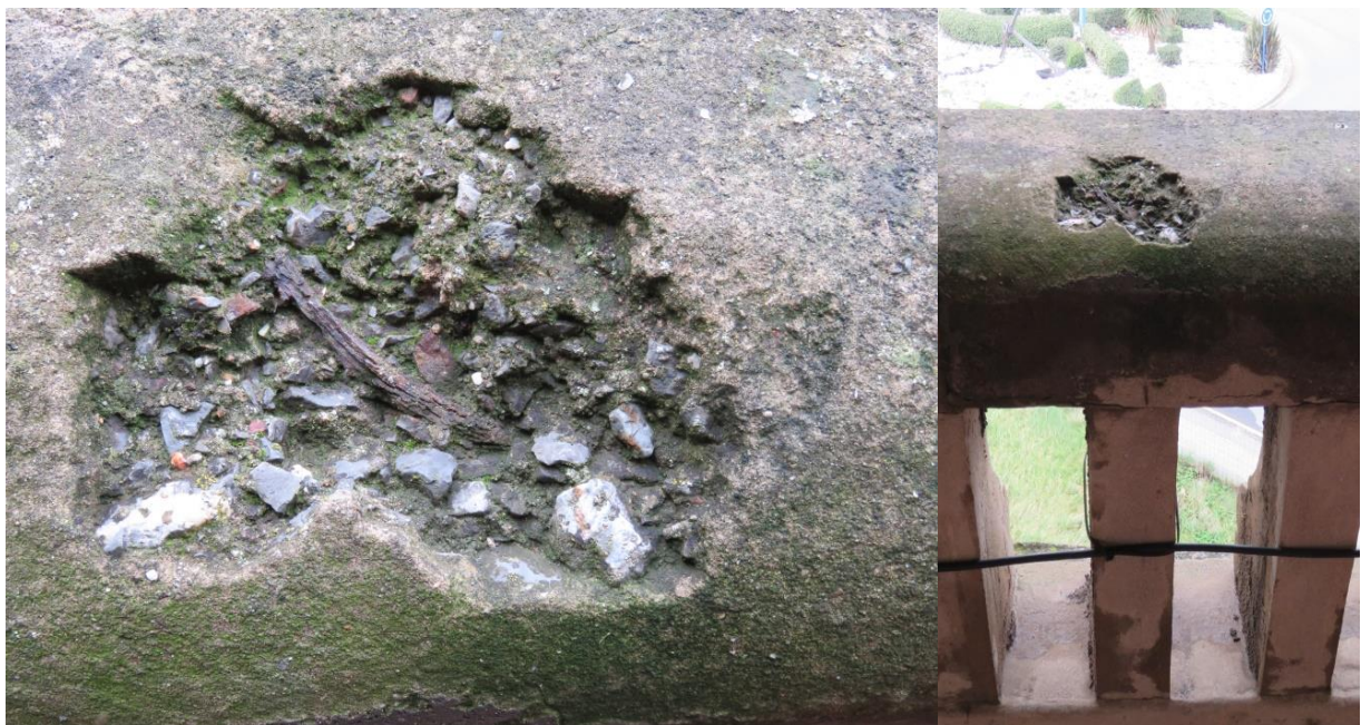
Figuras nº 19 y 20. Detalle y vista general de una pérdida por expansión de la armadura en un barandal superior de la galería NW. Grupo B.B.A.A. 2018.
