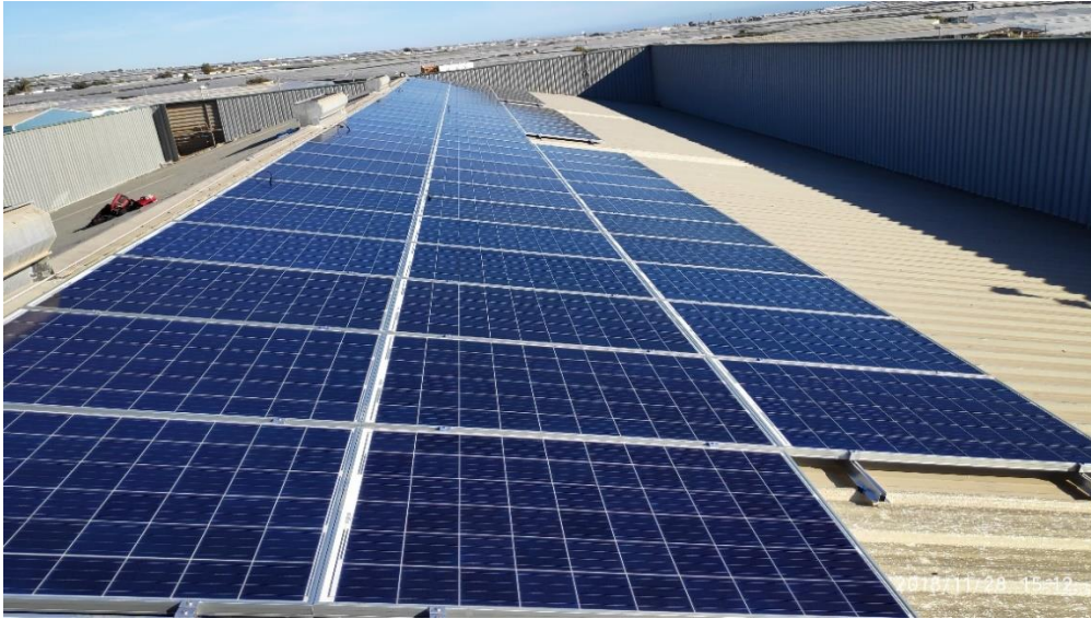
Imagen 6: Placas fotovoltaicas sobre cubierta. [5]
