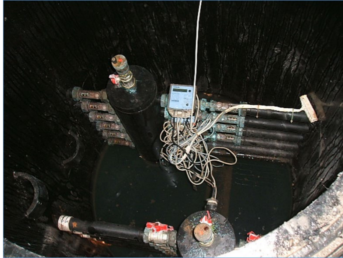
Figura 10. Acceso al pozo geotérmico.
