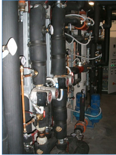
Figura 11. Vista parcial del sistema de distribución.
