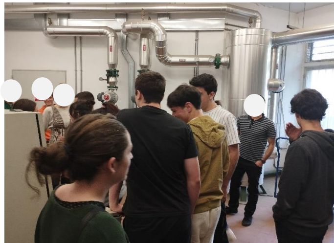
9 Irudia: Eskolako instalazio termikoak
