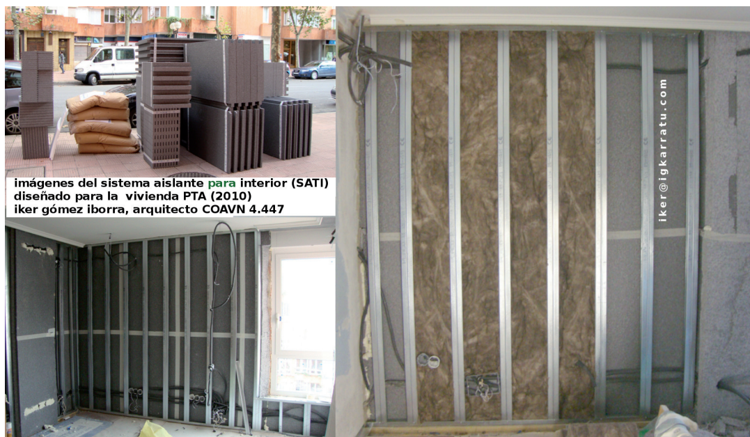
Fig. 4: Imágenes del sistema aislante
