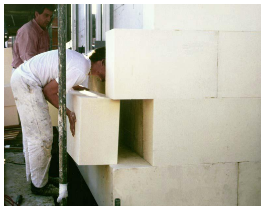
Fig. 3. Ejemplo de sistema constructivo de gran espesor mediante aplicación de nuevos materiales.
