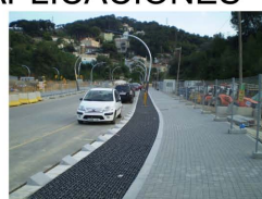
Rígola filtrante. Torrebaró, Barcelona
