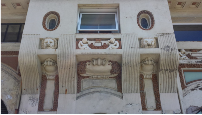
Fig. 3. Estado inicial de la ornamentación antes de la rehabilitación. Teatro del Príncipe. Kursaal Rehabilitaciones. 2014.
