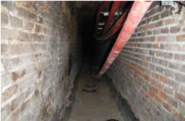
Cableado subterráneo, Madrid.
