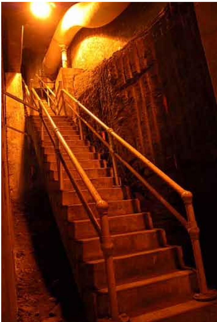
Fotografía de estructura subterránea. SOLIS, Julia: "New York Underground. The Anatomy of a City" . Routledge, 2005.
