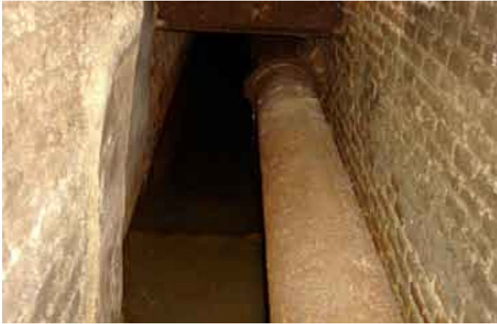
Conducto agua, subsuelo de Madrid.
