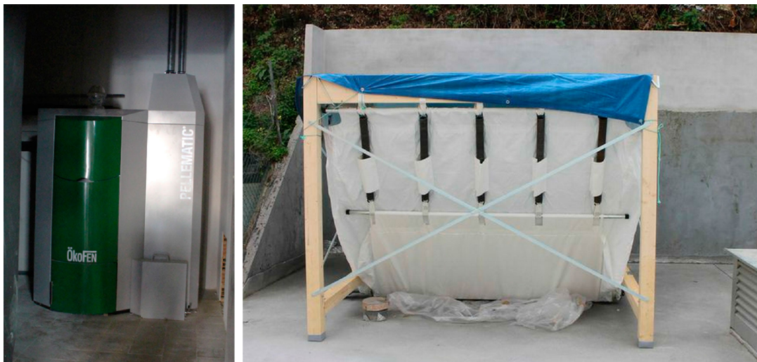
Fig. 6. Caldera de biomasa y silo de pellets instalados en edificio de viviendas.
