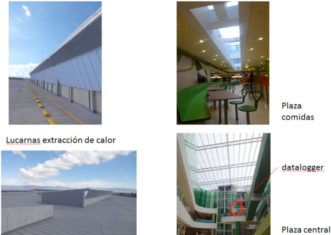
Fig. 3. Diferentes elementos del sistema de ventilación natural del edificio.
