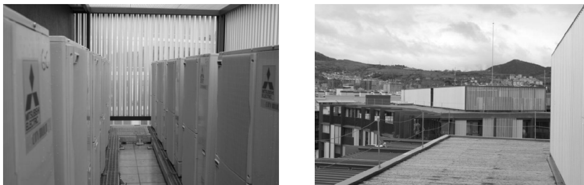
Figura 2.62. Instalación de refrigeración mediante sistema multisplit en el edificio de viviendas en Bilbao. Carlos Ferrater arquitecto. Imagen del autor
