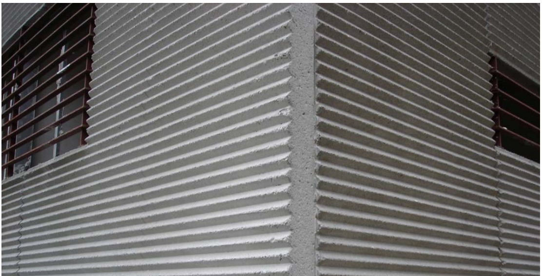
EDIFICIO DE 106 VIVIENDAS DE VPO EN EL PAU II DE CARABANCHEL. Detalle de fachada
