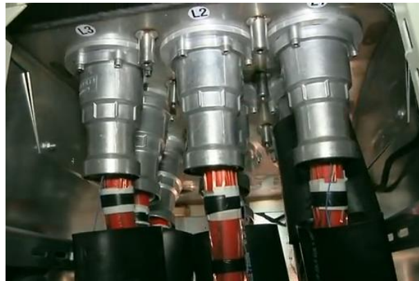
Figura 7: Detalle de un codo en una subestación eléctrica.
