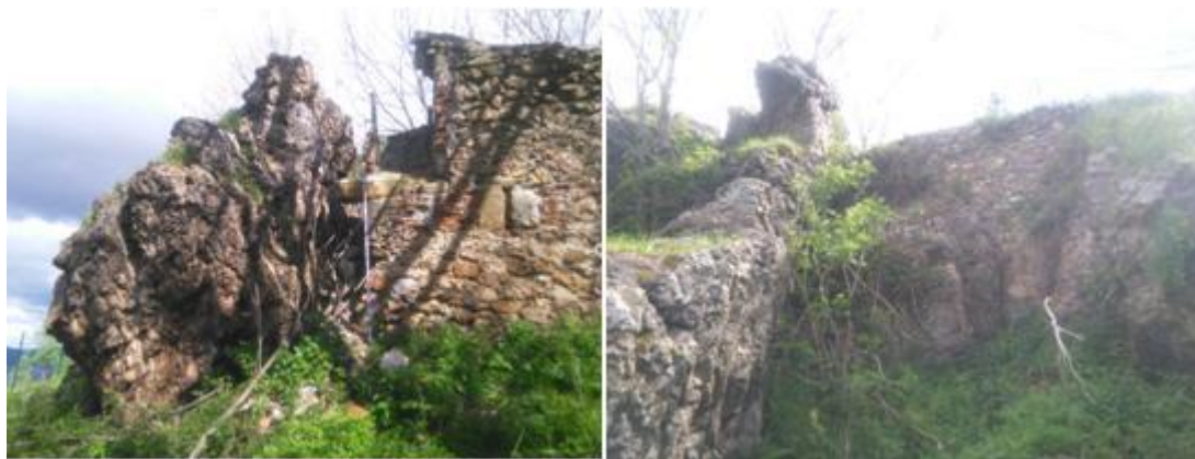
(Figura 22). Fachada norte al exterior, se observa como la roca natural es aprovechada para fortificar el lugar (fotografías del autor).
