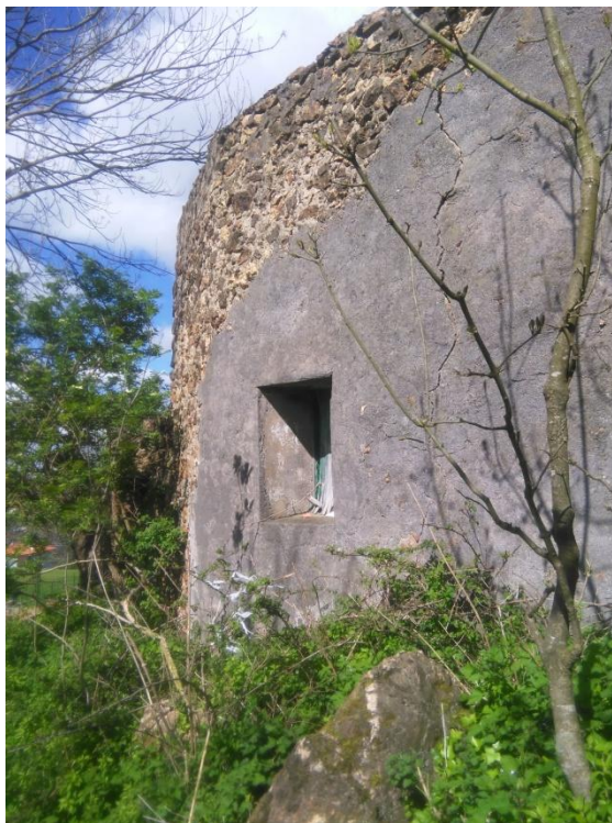
(Figura 23). Fachada oeste al exterior, se observa como el uso de cemento contemporáneo y la apertura de una ventana han afectado a la estructura original (fotografía del autor).
