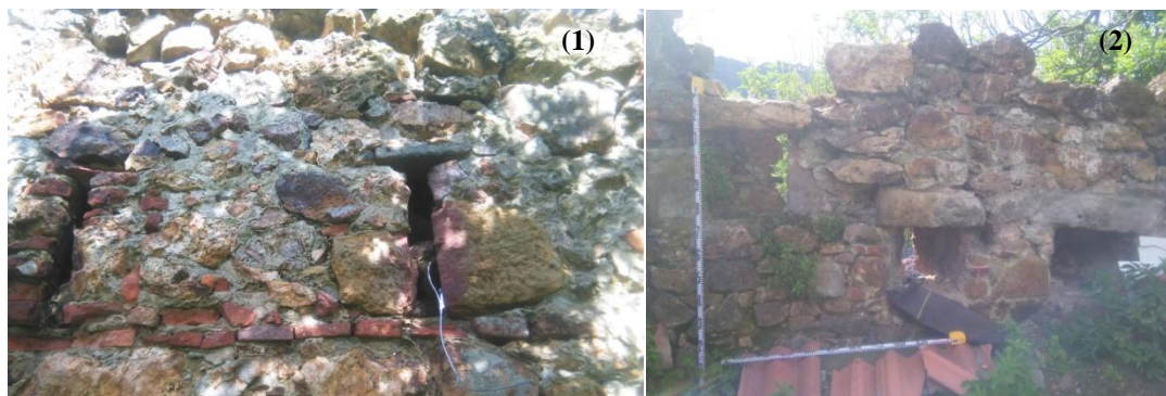
(Figura 21). Lienzo exterior de la fachada sur donde se observan dos aspilleras en las que se ha empleado ladrillo como nivelación y en la propia construcción de la apertura (1). Lienzo interior de la fachada oeste donde se observa el empleo de material constructivo de mayor envergadura y labrado para la construcción de las aspilleras (2) (fotografías del autor).
