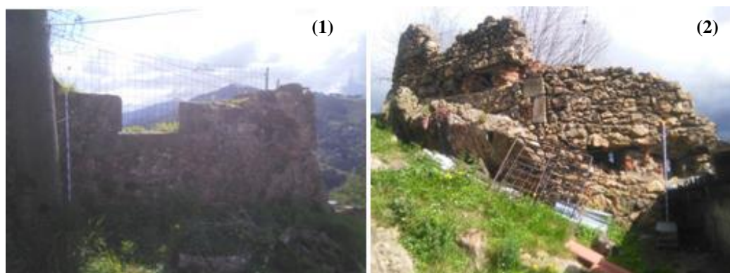
(Figura 20). Interior de la fachada sur. Se observa el empleo de sillares en la aspillera para artillería (1) y las troneras de fusilería que se abren en el codo sur (2) (fotografías del autor).
