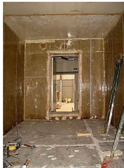
1.6 Irudia – Entsegu gelako infiltrazioen kontrolerako plastikozko kapa
