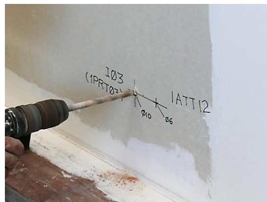
1.40 Irudia – Nomenklatura eta zunden instalazioa
