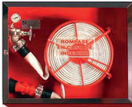
Figura 1. Boca de incendio equipada (BIE).
