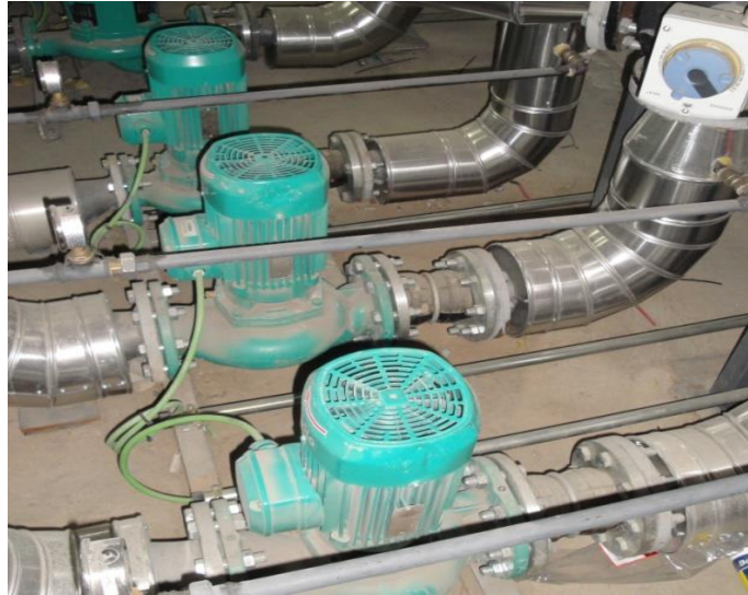
Ilustración 24- Bombas calderas de biomasa
