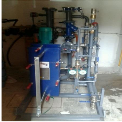
Ilustración 18- Intercambiador de calor subestaciones fase 1
