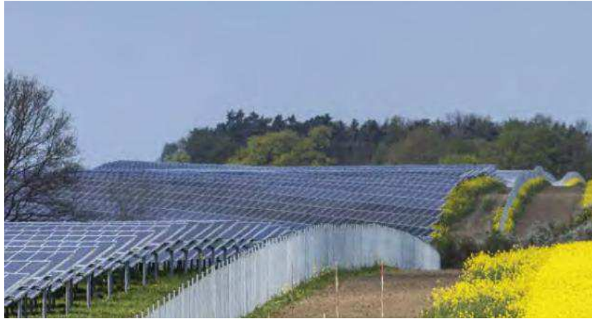
Imagen. Instalación solar fotovoltaica
