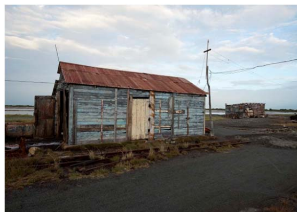
Figura 34. Caseta utilizada para guardar aperos y herramientas en las Salinas de Baní, República Dominicana..
