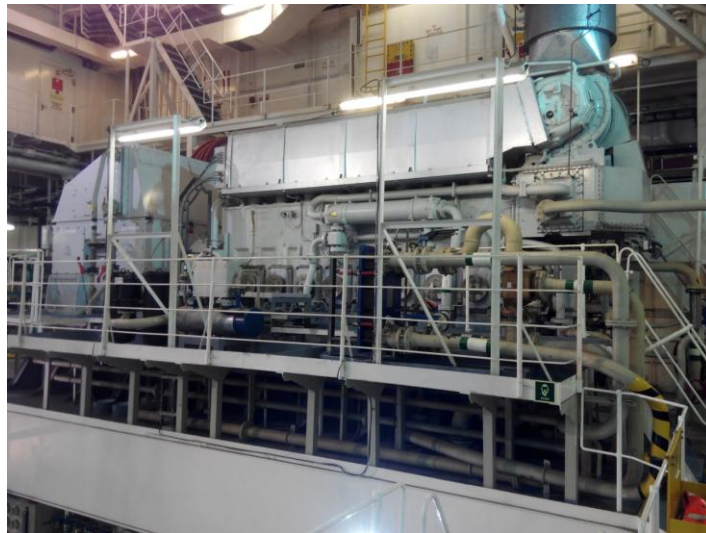
Figura 6: Motor diesel-generador. Fuente: propia
