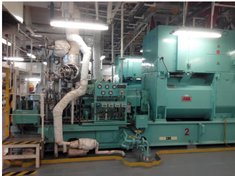
Figura 5: Turbogenerador de estribor. Fuente: propia
