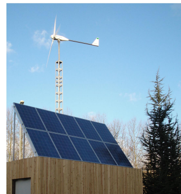
ILUSTRACIÓN 5 - Instalación minieólica y solar fotovoltaica aislada en el parque de eroski en Durango, Bizkaia (imagen de: ekidom)
