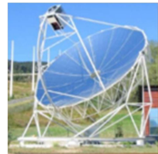
ILUSTRACIÓN 6 - Instalación minitermosolar (imagen de: unisolar.mx)
