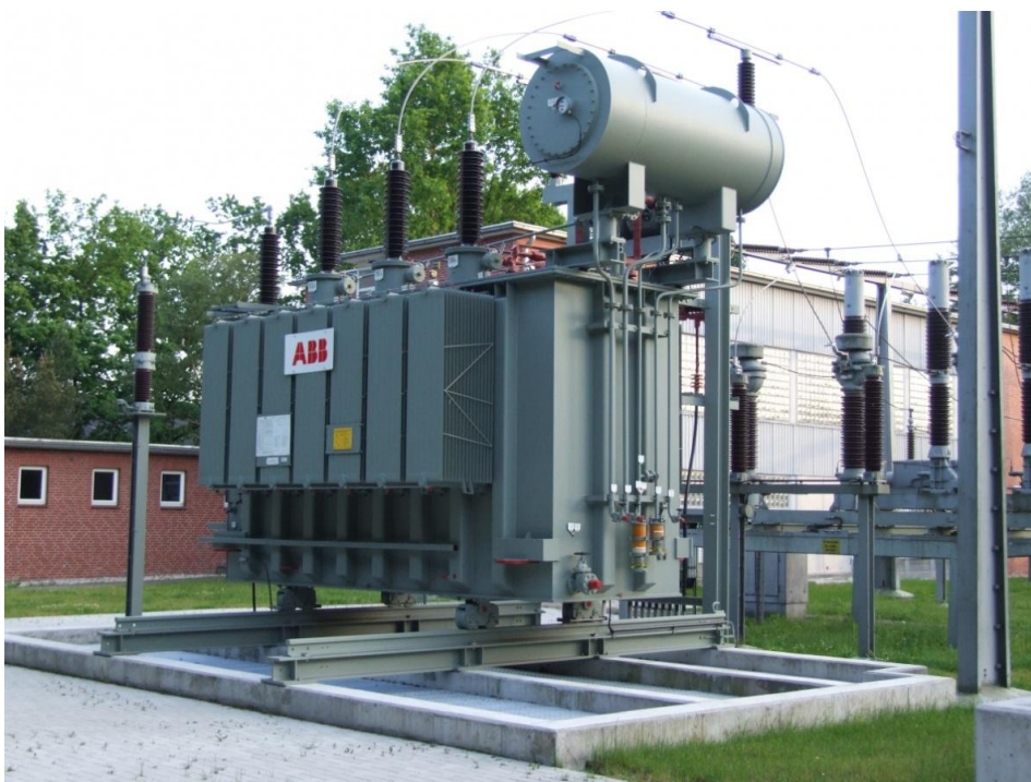
Ilustración 2: Transformador de potencia
