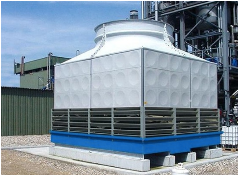
Fig. 16. Torre de refrigeración
