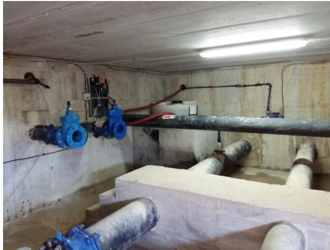
Figura 16: Tuberías de salida de los depósitos
