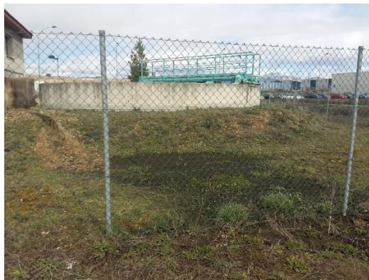
Figura 38: Lixiviado por fallo en impermeabilización de la EDAR Industrial
