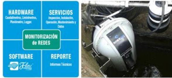
Figura 3: Monitorización de redes de saneamiento ECILIMP.
