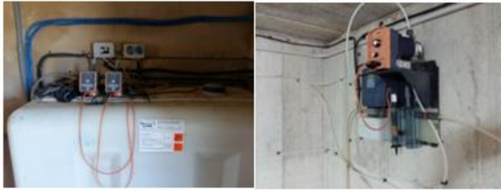
Figura 14: Tanque de hipoclorito sódico y bomba de pulsos
