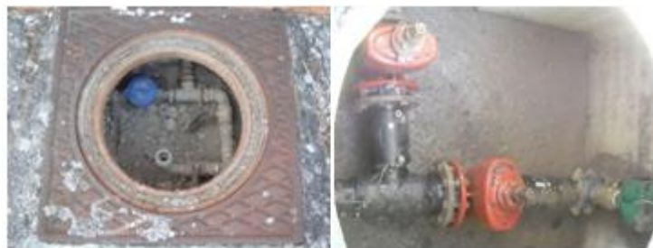
Figura 22: Contador de sector (Litutxipi) y seccionamiento asociado (Redes DFA)
