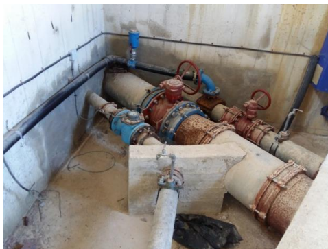
Figura 12: Llegada de las líneas de aducción al depósito
