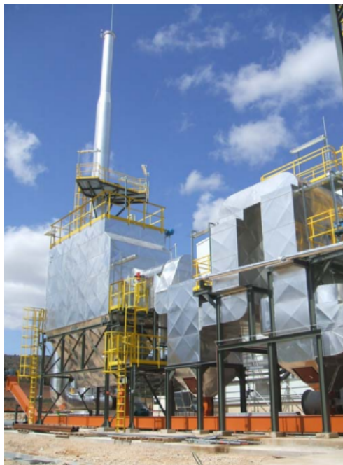
Ilustración 23. Filtro de mangas FIVEPULSE. Planta de biomasa de Villanueva de Algaidas (Málaga)
