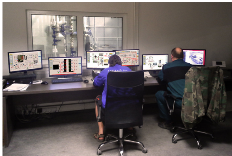
Ilustración 21. Imagen real de un SCADA para visualización y control de proceso de una planta de biomasa en kolin (República Checa).
