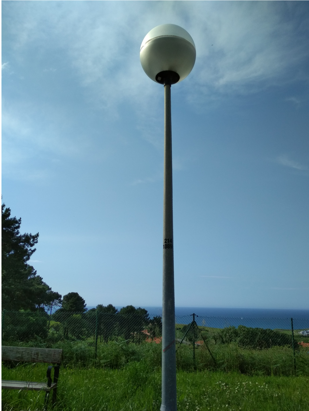
Imagen 5. Luminaria calle Landaluze
