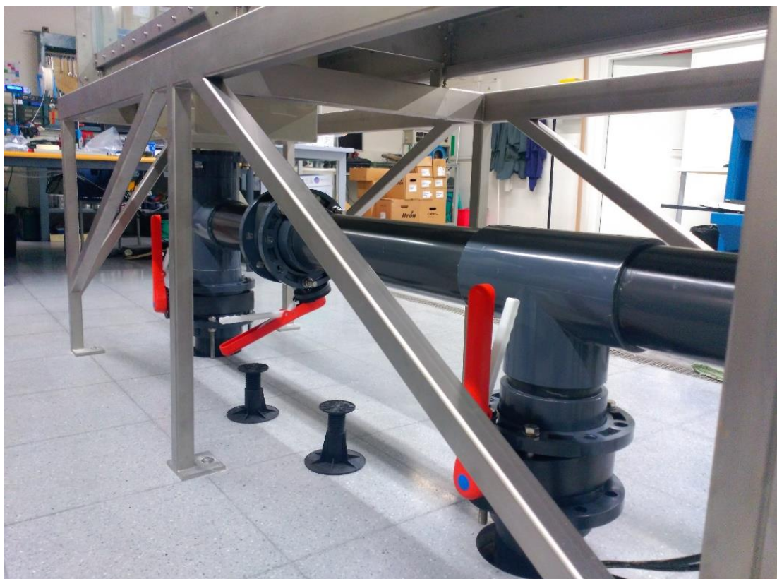
Ilustración 55: Conexión entre el depósito subterráneo y canal en la zona de extinción
