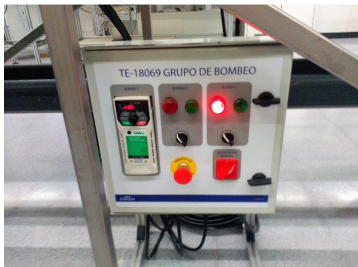
Ilustración 56: Sistema de control de las bombas
