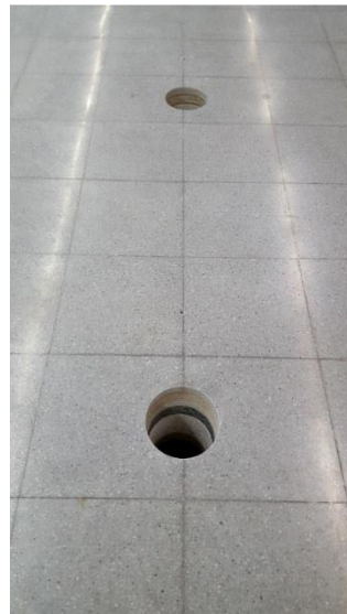
Ilustración 52: Orificios realizados para la conexión entre el canal y el depósito subterráneo
