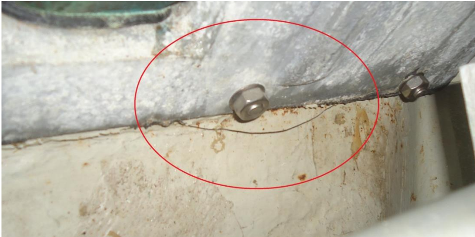
Figura 14: Fisuras en la fibra de la estructura del bote [Figura propia]
