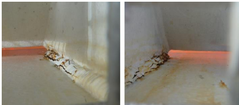
Figura 44: Óxido en las soldaduras de las uniones en la estructura del pescante [Figura propia]
