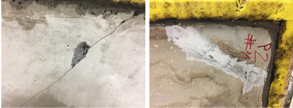
Figura 3.50: Muestra fisurada durante su manipulación y reparación realizada.
