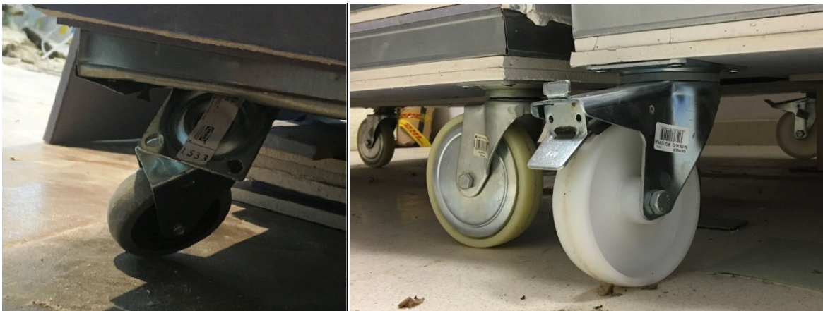
Figura 3.6: Ruedas iniciales (falta) frente a las definitivas, ya en su ubicación definitiva.
