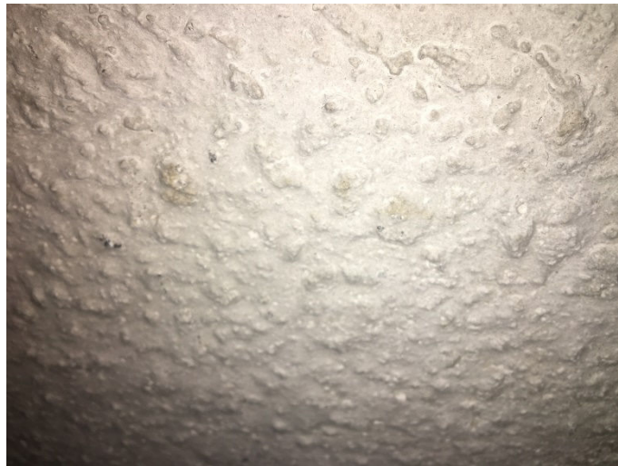
Figura 4.12: muestra de espesor no homogéneo debido a las propias texturas del hormigón bombeable.
