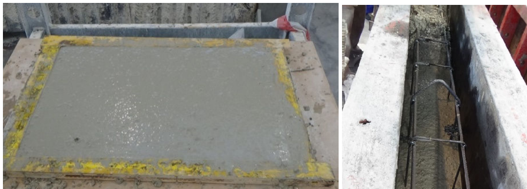
Figura 4.6: Probeta acústica y viga a escala real con las amasadas de diciembre de 2015 (autocompactantes).
