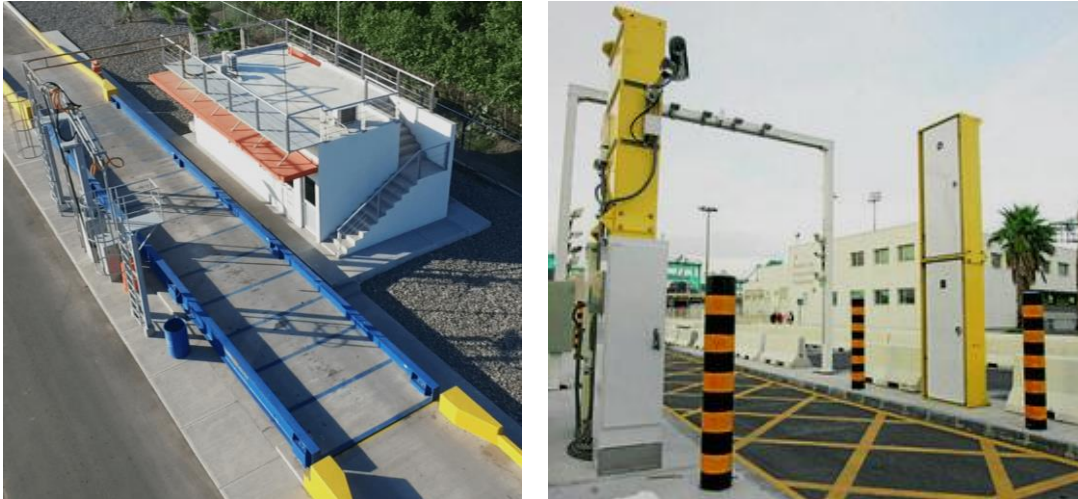
Ilustración 29. Zona de pesaje y arco de detección de materiales radiactivos
