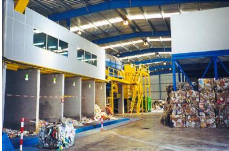
Ilustración 15. Planta de tratamiento TMB
