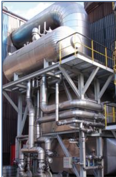
Ilustración 49. Caldera de recuperación
