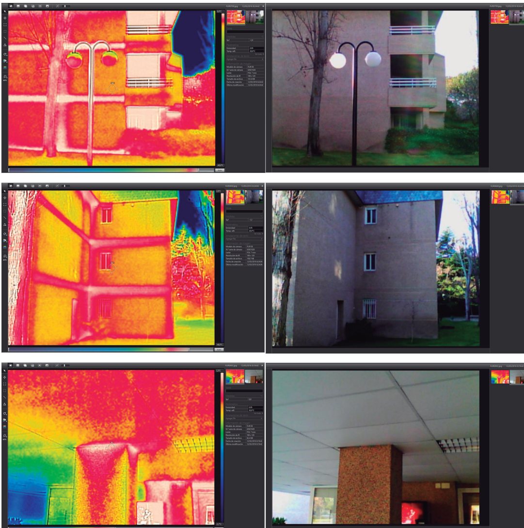
Figura 3. Imágenes termográficas realizadas en marzo de 2016 donde se evidencian las patologías anteriormente descritas.
