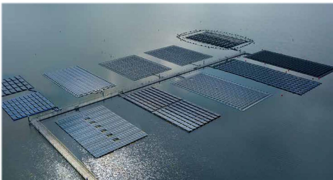
Figura 82: Aspecto final de la instalación en el embalse
