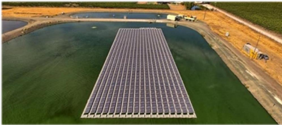
Figura 27: Planta fotovoltaica flotante de Kelseyville (EEUU) de 252 KWp. Fuente: Ciel et Terre
