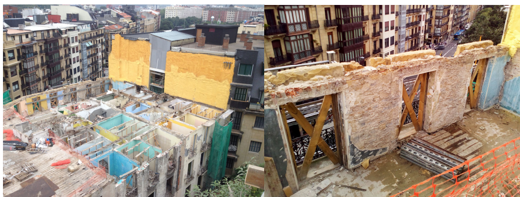
Figura 1. 18.-Envolvente de los bloques de edificios de la calle Easo de Donostia-San Sebastián durante la fase de deconstrucción.
