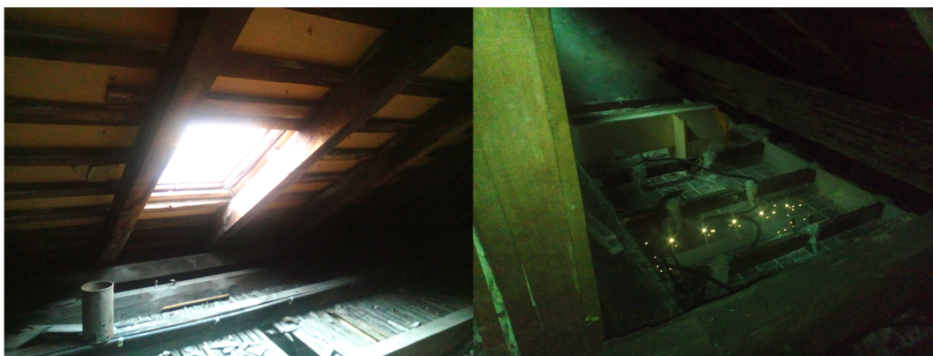
2. 17. Irudia- 30 F kasuaren gaineko ganbara eta sabaiaren zuloak.
