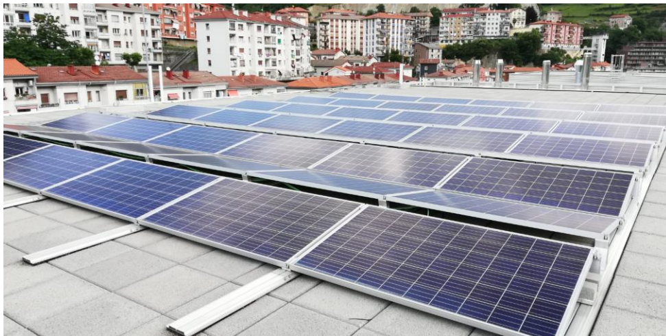
Ilustración 19: Instalación ya existente sobre la cubierta del hospital.
