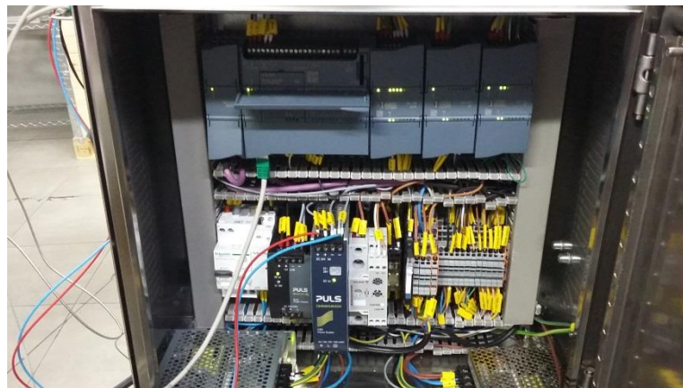
Figura 18. Controladores de la planta
