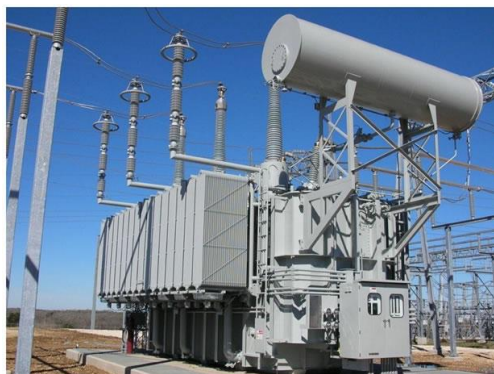
Figura 2. Transformador de potencia.
