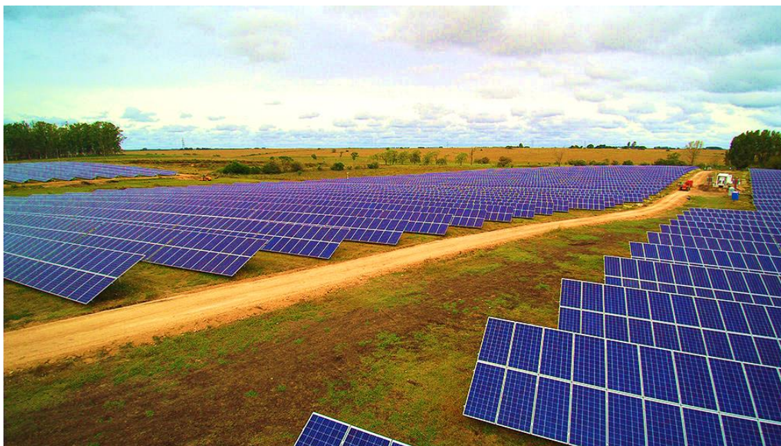
Ilustración 1. Proyecto de generación, planta fotovoltaica en Yarnel, Uruguay. Fuente: www.solariaenergia.com
