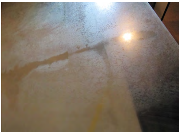
Fig 66 Detalle del cristal con humedad
