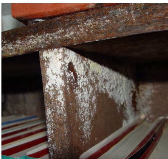
Fig 6 Vista en detalle de la presencia de hongos.
