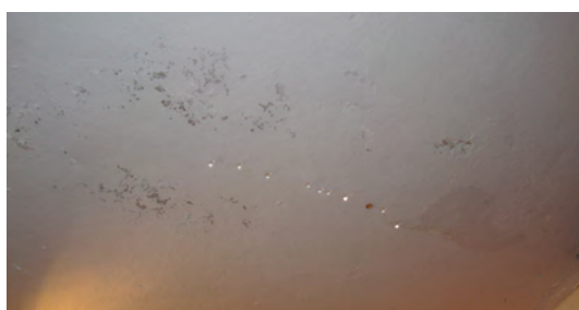
Fig 13 Detalle de gotas en el techo por condensación
