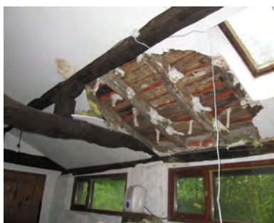
Fig 10 Derrumbamiento de techo
