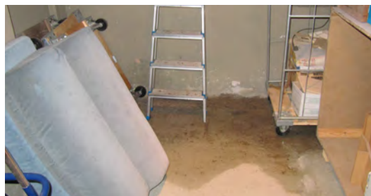
Fig 16 Agua por filtración
