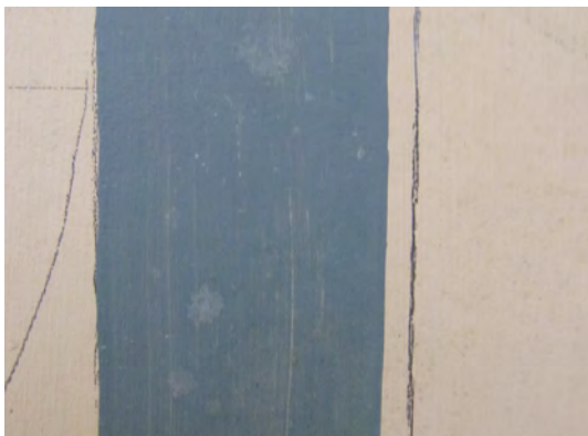
Fig 81 Detalle de manchas blanquecinas
