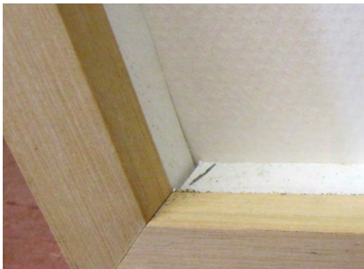
Fig 72 Detalle de suciedad en el interior del marco
