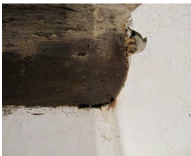
Fig 7 Vista en detalle de una viga con ataque de xilófagos
