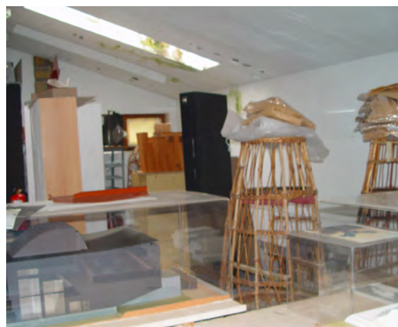
Fig 26 Vista parcial del garaje principal. Se aprecia verdin y manchas de humedades en el techo
