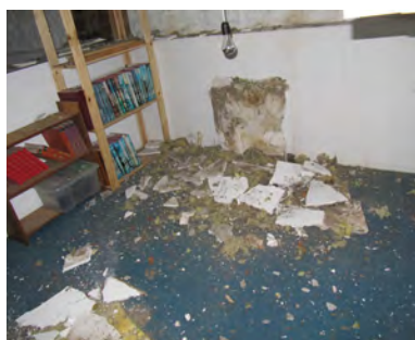
Fig 11 Vista de los escombros caidos
