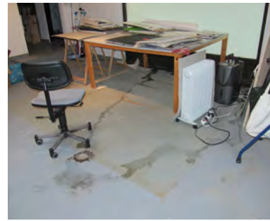
Fig 12 Filtración del agua a través de la entrada del garaje
