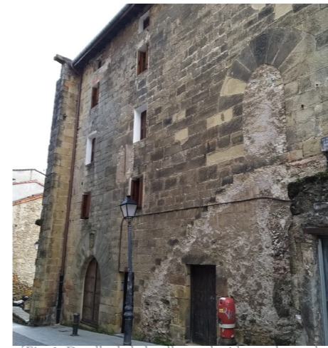
[Fig. 1: Detalle de la huella producida por la escalera anteriormente existente.]
