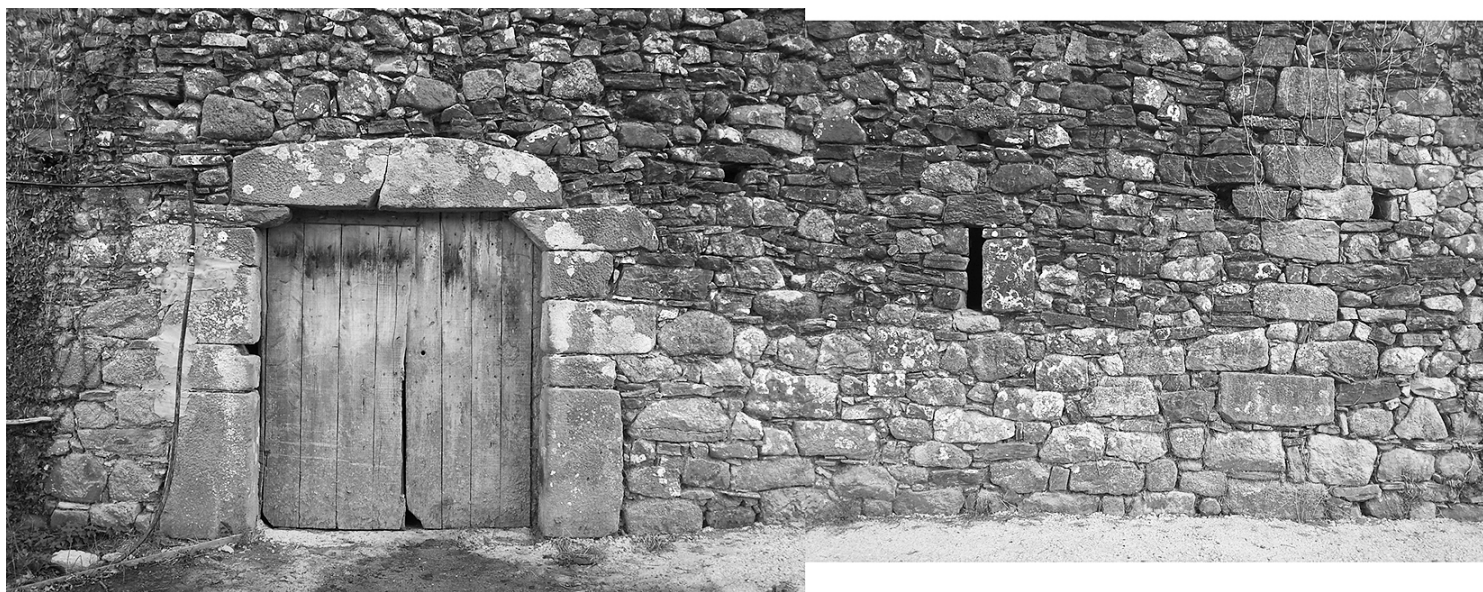
Figura 6. Fachada trasera del caserío Barrenetxea. Apertura de ingreso y macla constructiva entre el edificio originario renacentista y la intervención barroca. Fuente propia.
