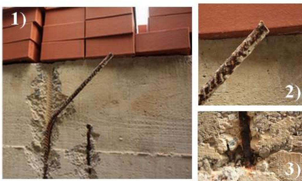
Figura 4.1: imágenes tomadas sobre andamio de los aceros corrugados de Donostia. Este acero se encontraba al aire (imagen 1), con costras blancas (imagen 2) y presentaba desprendimientos en forma de lascas (imagen 3).
