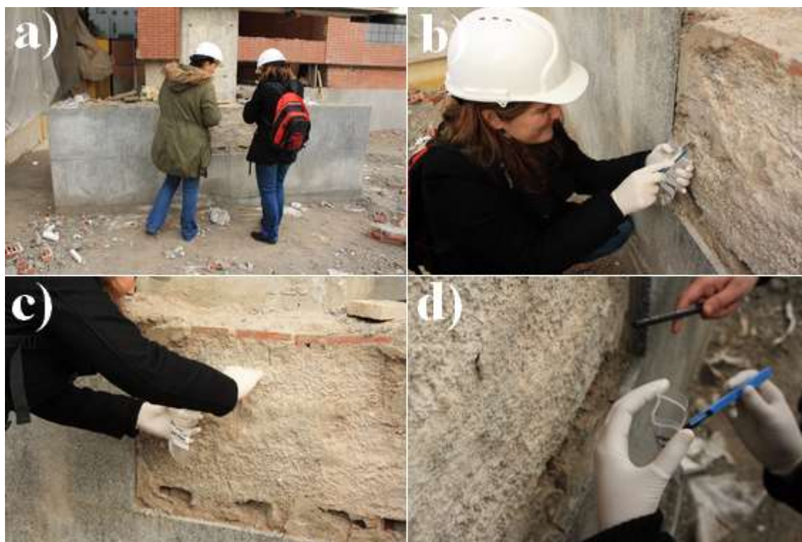
Figura 5.14: imágenes del muestreo de un mortero de unión entre hormigón y granito de Donostia que presentaba pérdidas de material y eflorescencias.
