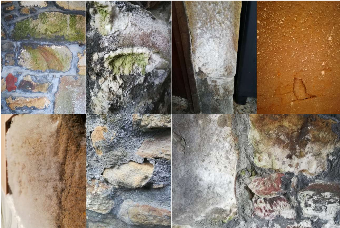
Figura 1.7: apariencia de las eflorescencias sobre diferentes materiales de construcción
