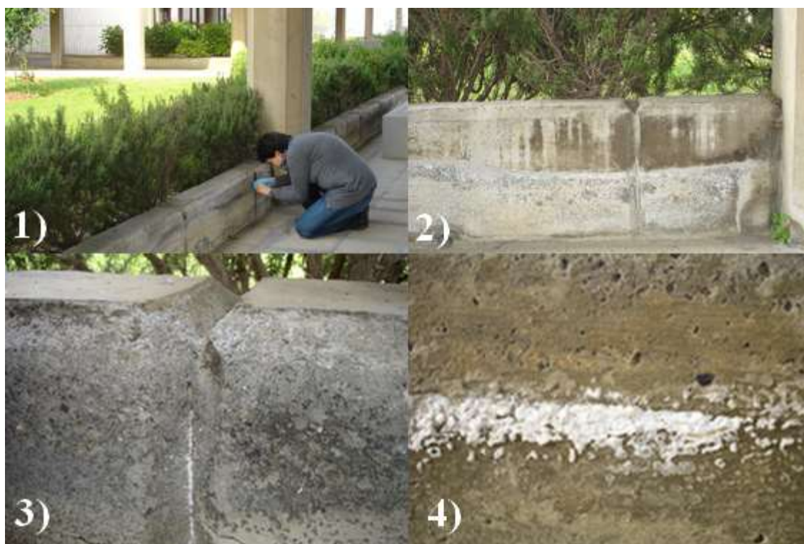
Figura 4.7: imágenes del muro bajo de hormigón armado analizado de Leioa (imágenes 1 y 2); las imágenes 3) y 4) muestran además los detalles de las eflorescencias encontradas en dicho muro.
