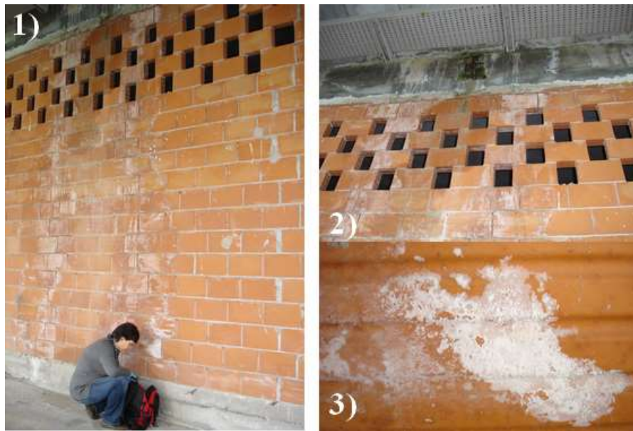
Figura 4.11: detalles de las afecciones ambientales encontradas en ladrillos de Leioa: lixiviación de las estructuras superiores (imágenes 1 y 2) y aparición de eflorescencias (imagen 3).
