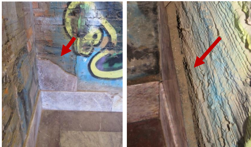
Figura 3.9. Parte de un paño central de mármol que un sigue en pie. Se puede observar cómo no hay mortero de unión entre el mármol y la pared.
