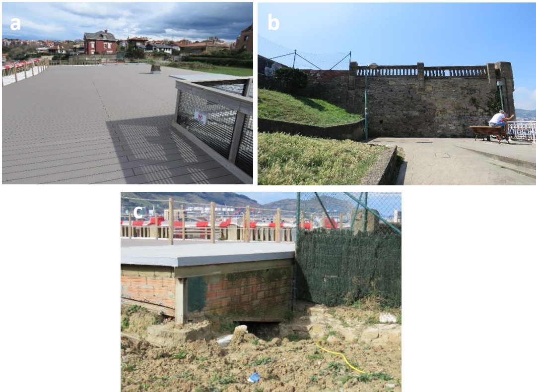
Figura 6.2. a) Aislamiento del techo del salón, b) Jardín exterior que se une con la pared izquierda de la 1ª crujía. Las humedades y aguas subterráneas de esta inclinación del terreno penetran en el salón y c) Hueco abierto que conecta con las escaleras de la 1ª crujía.
