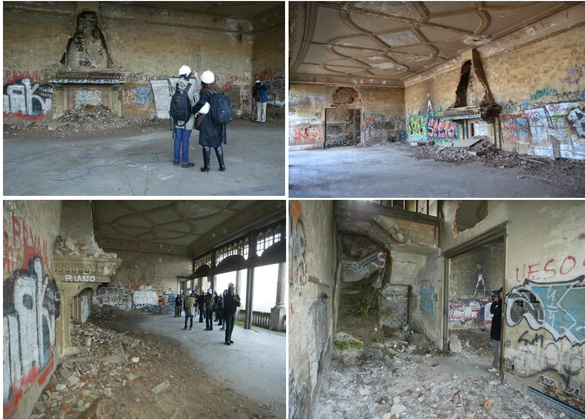
Figura 2.6. Distintas fotografías de estado del salón y 1ªcrujía en el año 2007. Fuente: GPAC-UPV/EHU.
