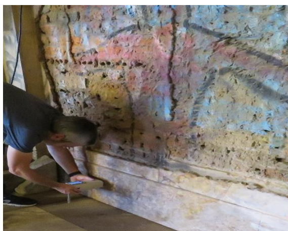
Figura 5.6. Mediciones en los zócalos del salón. Esta operación se repitió en todas las paredes que contaban con este recubrimiento y permitían la medición de este.
