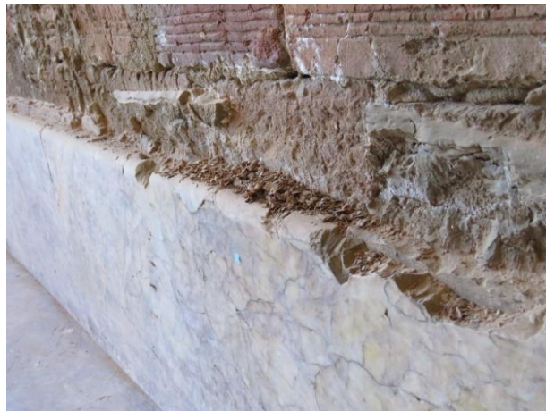
Figura 3.11. Detalle de los desprendimientos del mármol de los zócalos. El agua, junto con otros agentes, facilita la fisura de este tipo de mármol.
