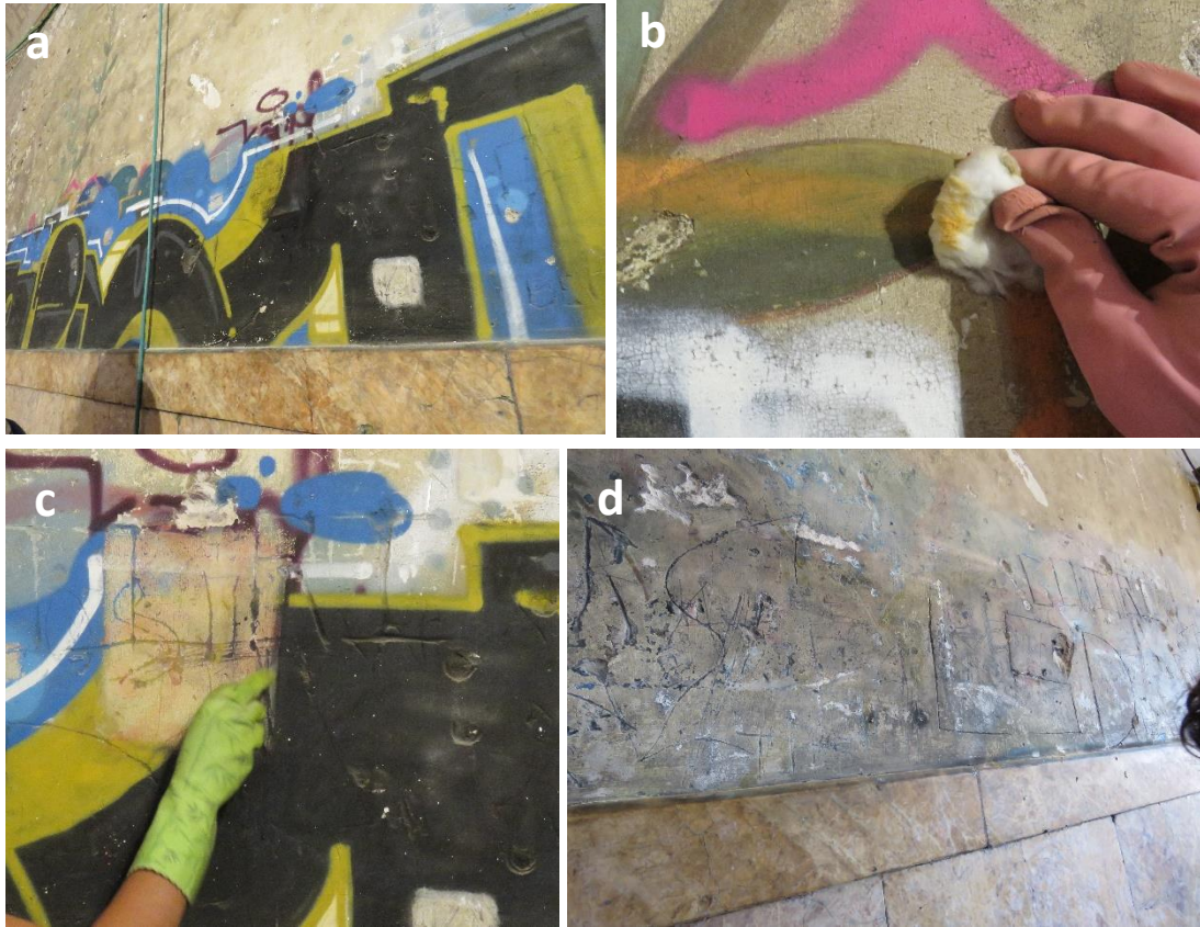
Figura 7.22. a) Pared 4 antes de la intervención, b) Prueba realizada con acetona en pintura mural con grafiti, c) Aplicación y retirada del decapante en ventanas controladas y d) Aspecto final de la pared tras estos trabajos.
