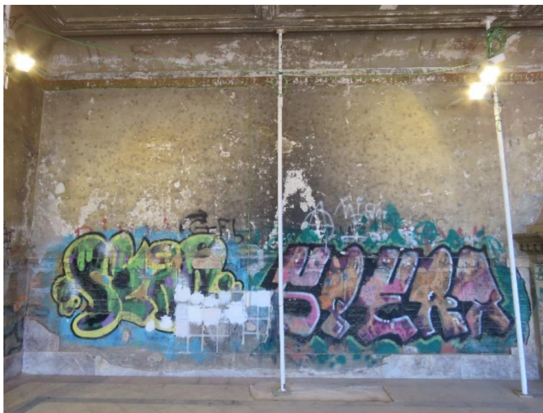
Figura 4.26. La hoguera realizada en esta pared ha conllevado la pérdida de este conjunto iconográfico.
