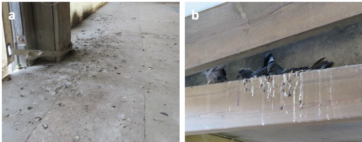
Figura 3.16. a) Excrementos de palomas en el suelo del salón, llegándose a acumular varias capas y, b) Nidos de palomas en las estructuras actuales de acceso a las galerías.
