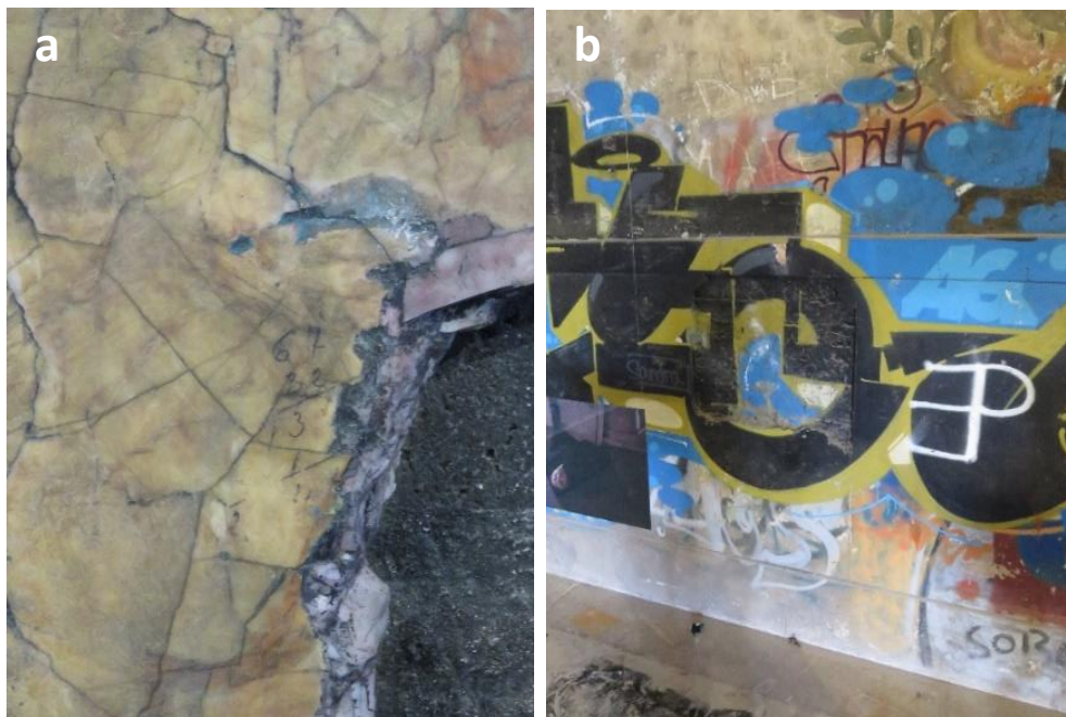
Figura 3.13.a) Detalle de las tintas dentro de las vetas del mármol y, b) Grado de afección de los grafitis en los paños de mármol.
