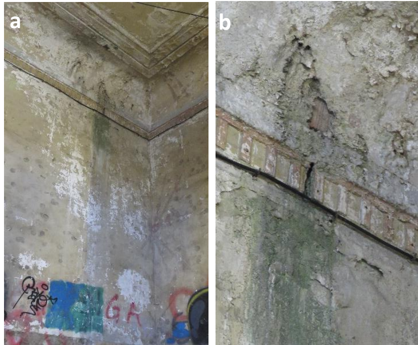
Figura 7.23. a) Esquina de unión de la pared 3 con la pared 4 con crecimiento microbiológico, y b) Detalle del aspecto del punto afectado.
