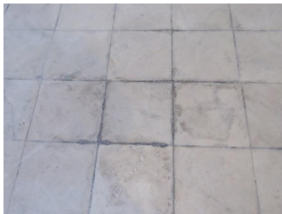
Figura 3.18. Detalle del posible rezumado de los morteros de unión de las baldosas del suelo de mármol blanco de Carrara, debido a las sales provenientes del subsuelo del salón.
