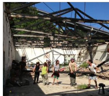
Imagen 15. Nave quemada. Fuente: Calafou, 2013.
