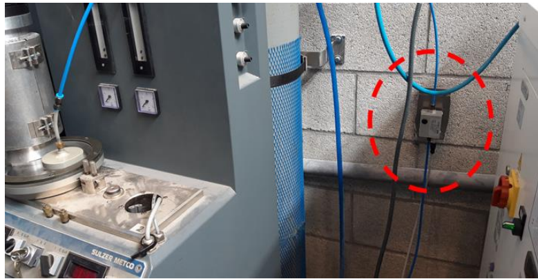
Figura III-9. Colocación del sensor al lado del alimentador de polvo.
