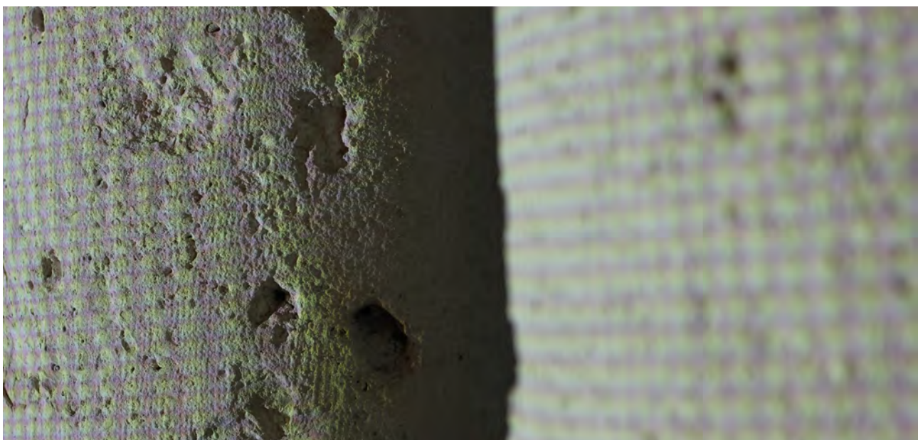
Detalle del impacto de las balas en la superficie de las columnas.
