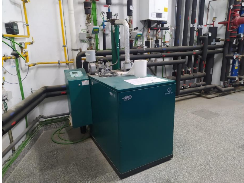
Imagen 27. Motor de cogeneración
