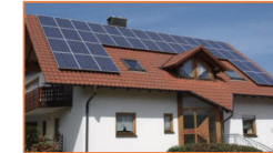
Aislada sistema solar casero
