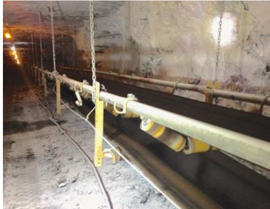
Ilustración 5. Banda transportadora en tramo subterráneo
