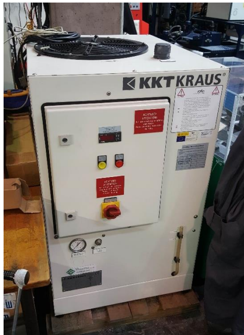
Ilustración 27. Equipo de refrigeración.
